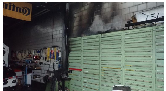
Die Brandmeldeanlage war in diesem Fall Gold wert.
