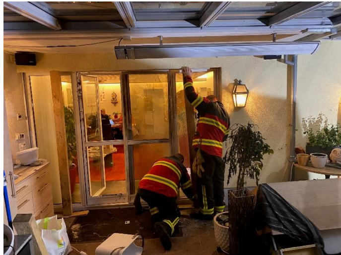
Terassentür-Sicherung nach der Explosion
