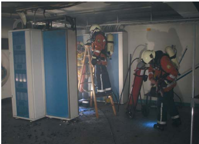
Einsatz mit CO 2 unter Atemschutz.
