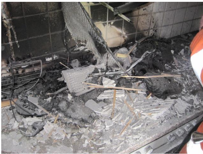
Der Bereich des Kochherdes
